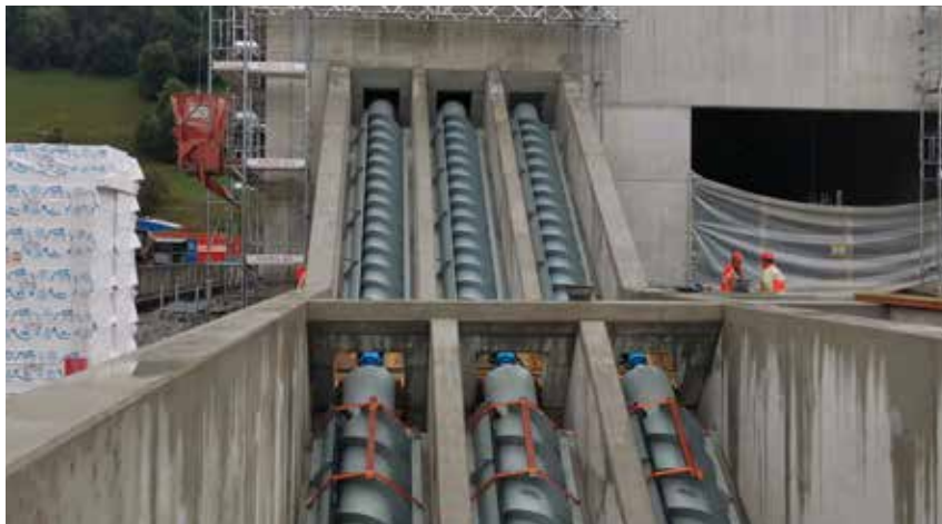
Mehr Betriebssicherheit: Sechs Schneckenpumpen fördern hier künftig Abwasser.
