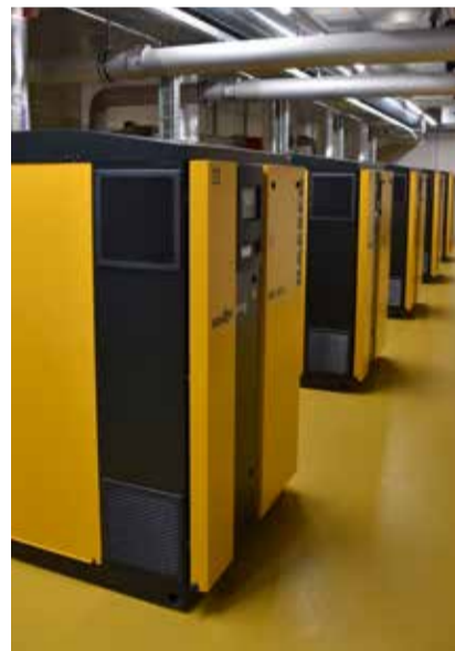
Effizienz pur: Die neuen Schraubengebläse lüften die Klärbecken auf nachhaltige Art.
