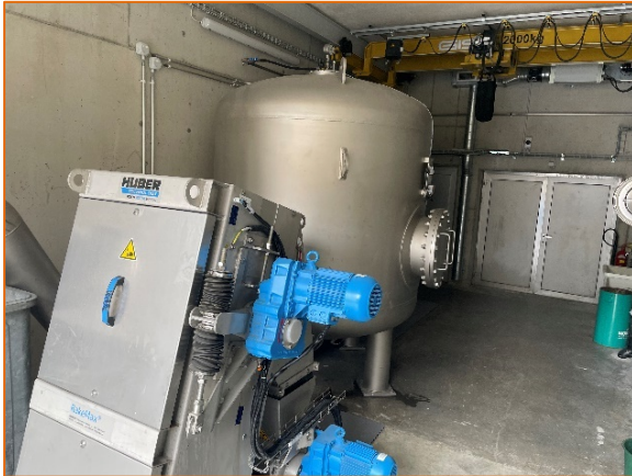
Rechenanlage und Druckschlagdämpfer im Pumpwerk Seidenbaum.
