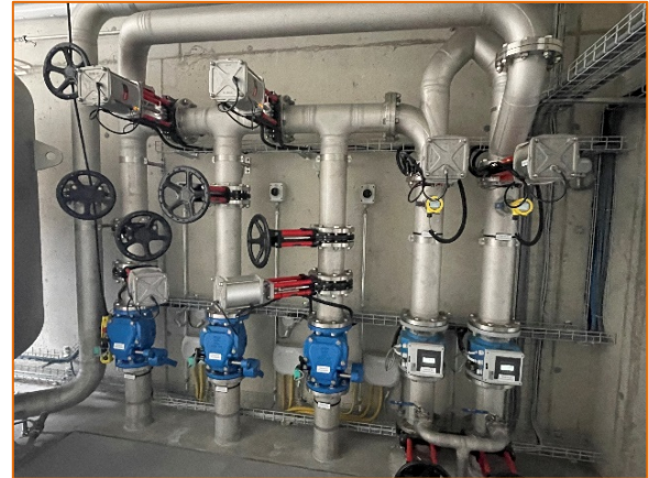
Verrohrung mit Armaturen und Durchflussmessungen der beiden Druckleitungen.
